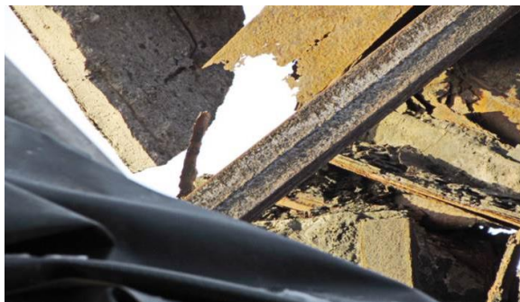
Рисунок 2. 100 %-ая коррозия стенок надпорной стойки 3-4 на опорном участке
