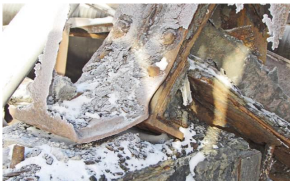
Рисунок 3. Разрушение анкерного сопряжения надпорной стойки 3-4 и фермы (узел 4) с ж/б колонной
