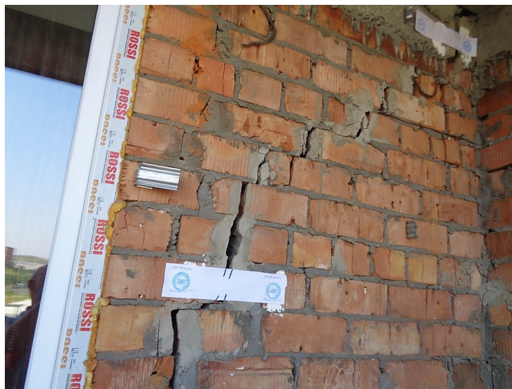
Рисунок 5. Трещина в кирпичной кладке стены первого этажа
