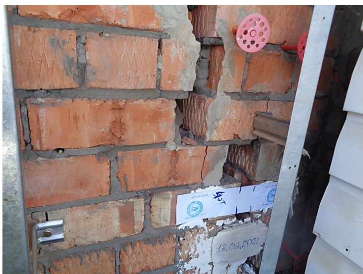
Рисунок 4. Трещина в кирпичной кладке стены четвертого этажа
