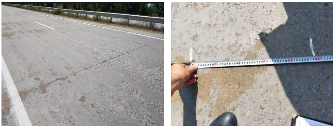
Рисунок 3. Шелушение ЦБ дороги
