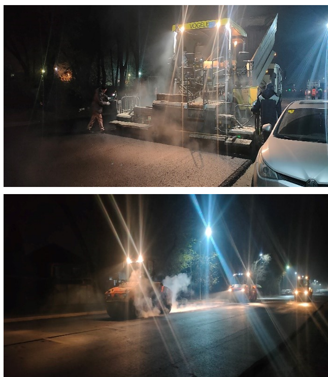
Рисунок 2. Укладка опытной партии асфальтобетонной смеси на основе окисленного битума, модифицированного резиновой крошкой
